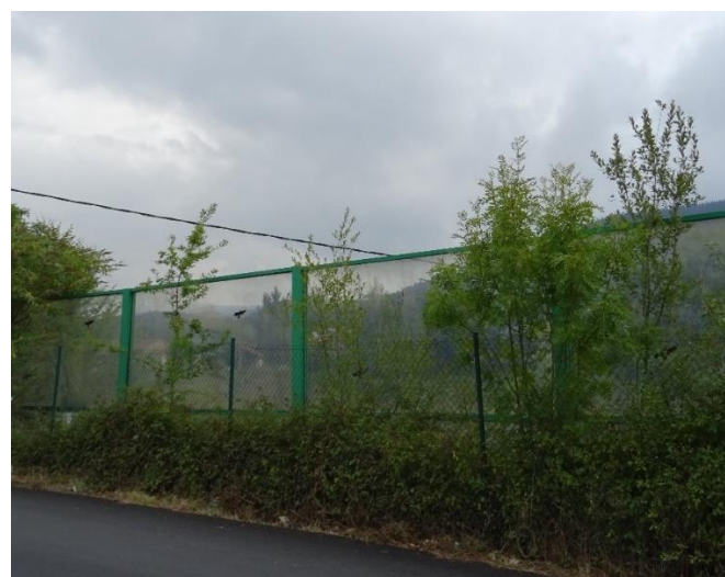
Pantalla acústica y cerramientos afectados
